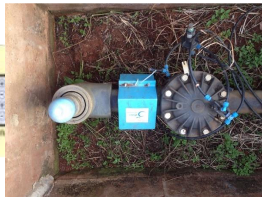
Figura 2. Instalação do magnetizador no sistema de irrigação
